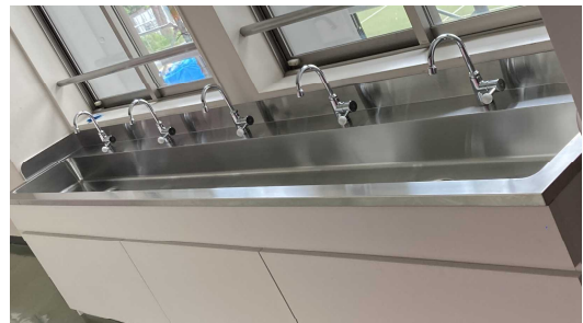
西館2F・3F・4Fに増設された手洗い場
